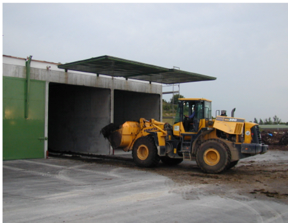
Betonfermenter mit Wand- und Bodenheizung
