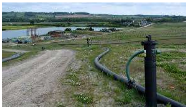
Landfill gas collection
